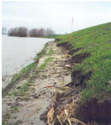
Figuur 16 dijkerosie buitentalud (bron: Wiki noodmaatregelen)
