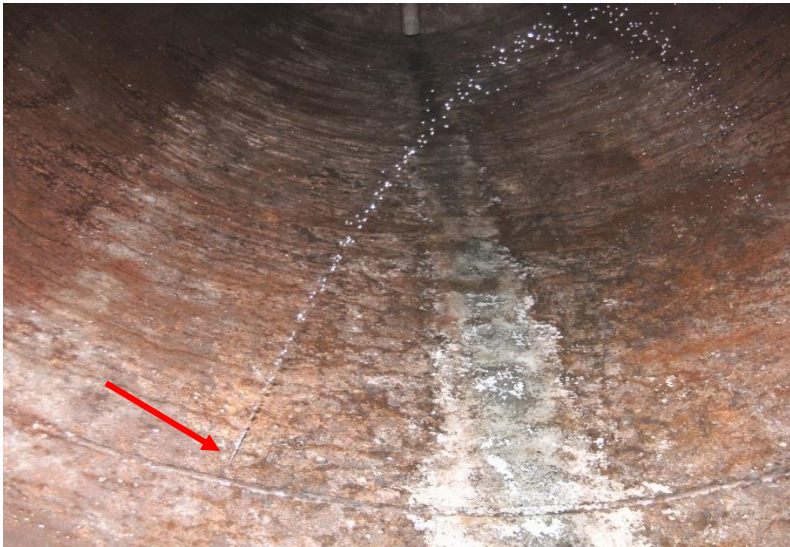
Figuur 1-1: Lekkage in tankwand t.g.v. corrosie
