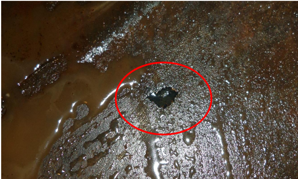
Figuur 5-3: putcorrosie dieseltank 2 Wolvega
