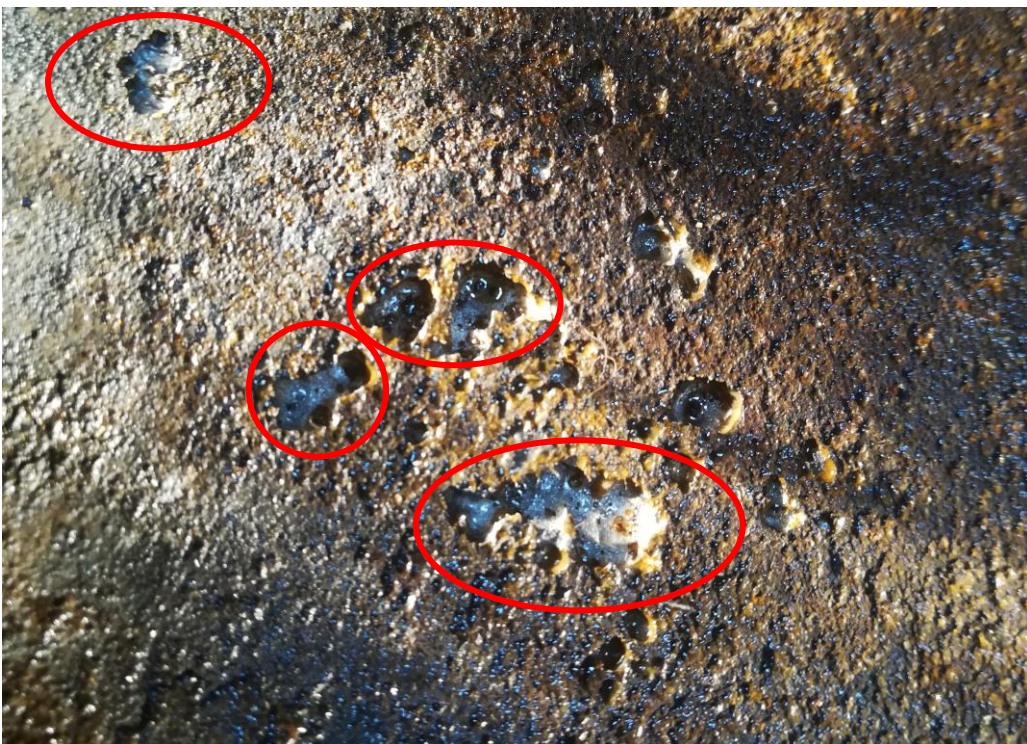
Figuur 5-4: putcorrosie dieseltank Barneveld
