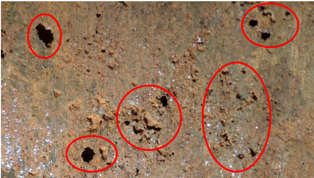
Figuur 5-6: putcorrosie dieseltank Groningen de Wijert
