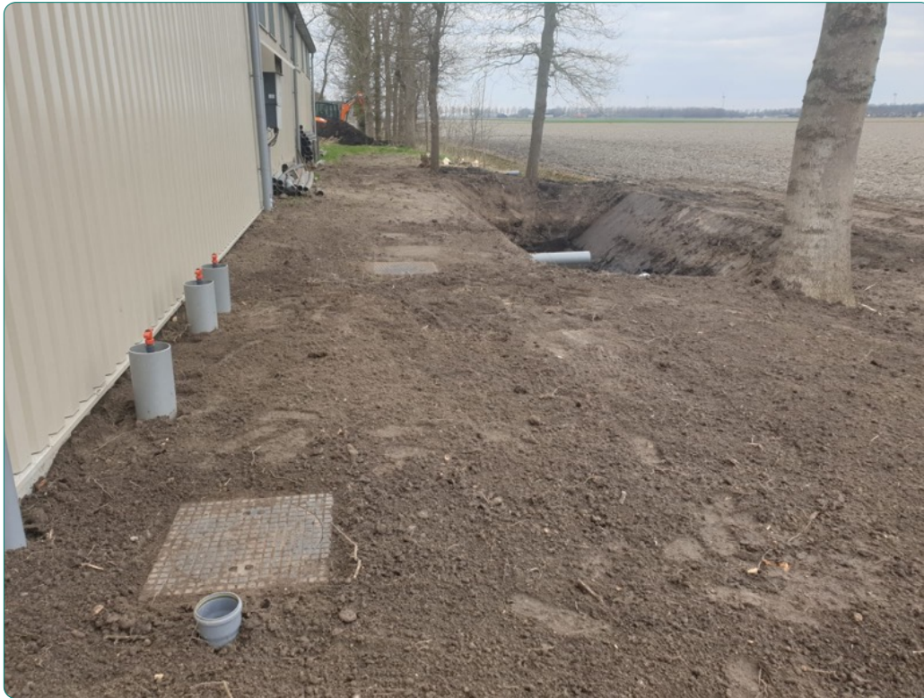
Een (gegraven) infiltratievoorziening waarop waswater zonder gewasbeschermingsmiddelen wordt geloosd.
