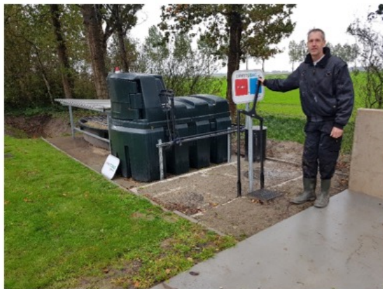
Wasplaats met zuiveringssysteem en tweewegklep
