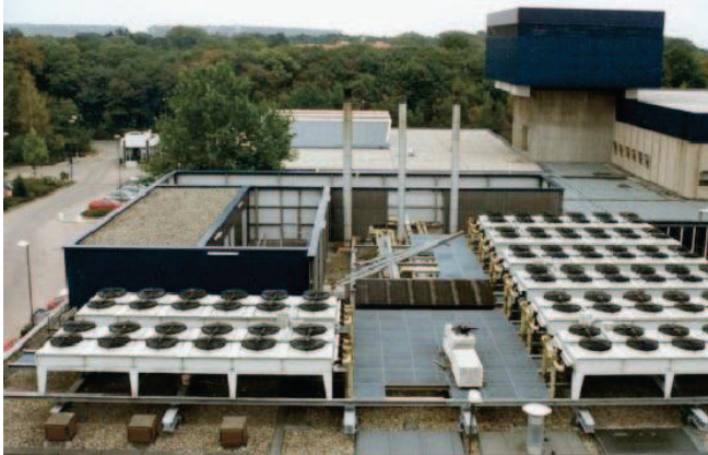
Figuur 13 Voorbeeld van droge koelers op het dak van een gebouw
